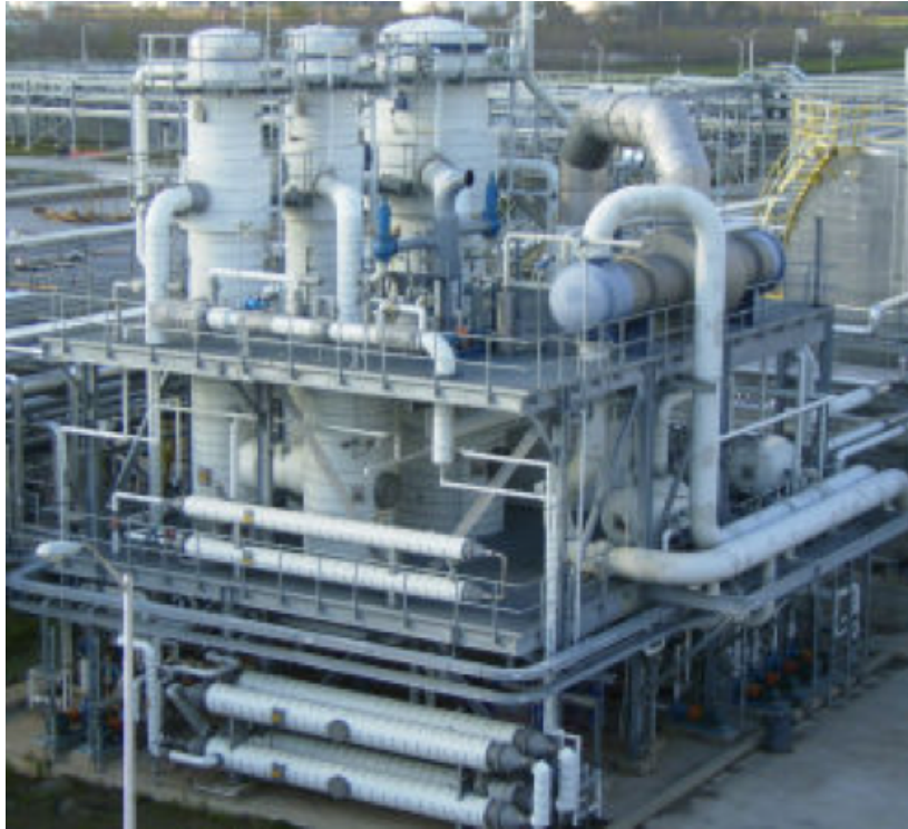
รูปที่ 1-4 หอระเหยเพิ่มความเข้มข้นโซดาไฟ (caustic evaporator)
